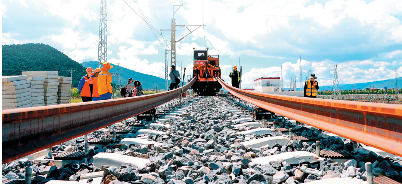
9月16日，丽江至香格里拉段铁路铺轨机组顺利进入香格里拉站，图为工人正在进行铺轨作业。 和丽瑶 摄
